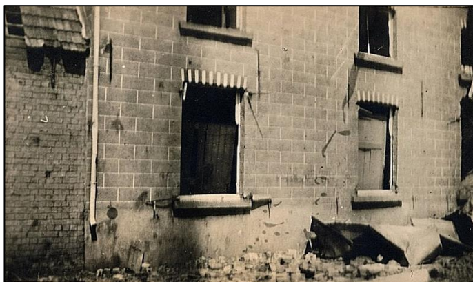
Kant sas - ook zwaar beschadigd en onherstelbaar.
